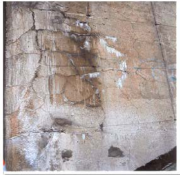
Brücken im Bereich Halle / Merseburg, errichtet Mitte der 70er / 80er Jahre (AKR nachgewiesen)
